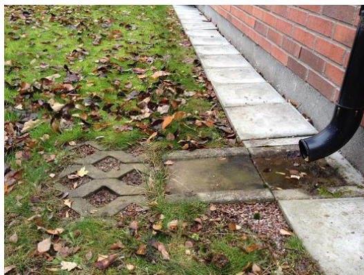
Figur 10 Utkastare med infiltration
